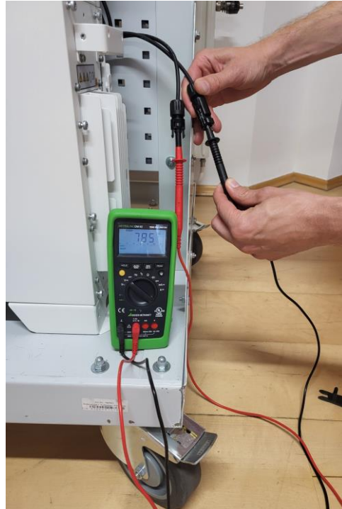
DC-Anschlusskabel vom Wechselrichter zum BMS kontrollieren an den Anschlüssen, welche mit dem BMS verbunden sind
