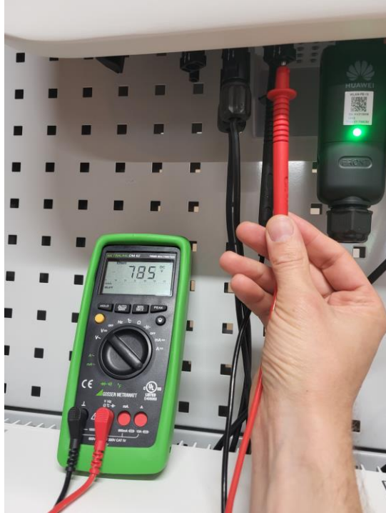
Ausgangsspannung an den Batterieanschlüssen des Wechselrichters messen
