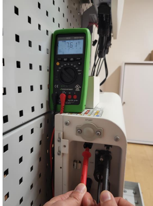
DC-Spannung am BMS messen
